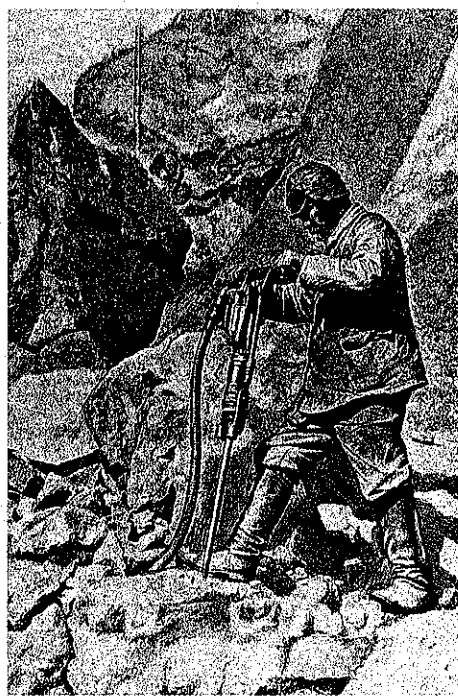
Бурение шурфов для взрывных работ в горах Алатау на южном участке Турксиба. 1927
